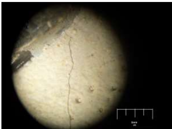
Рис. 4. Фрагмент трещины 1 из рис. 3, a (увеличение \times 25 )
